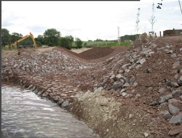
Beckenlauf mit höhendefinierter Überlaufschwelle
